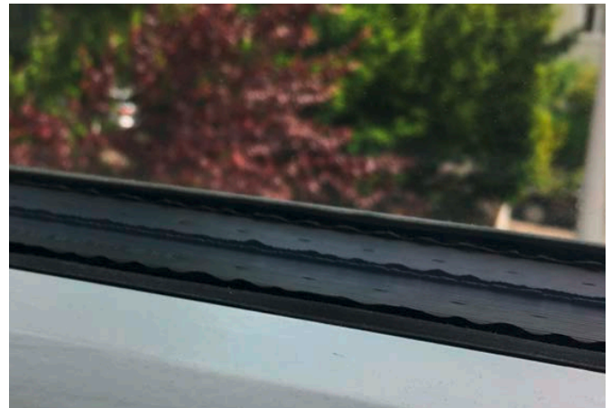
Butylquetschung im Scheibenzwischenraum.
